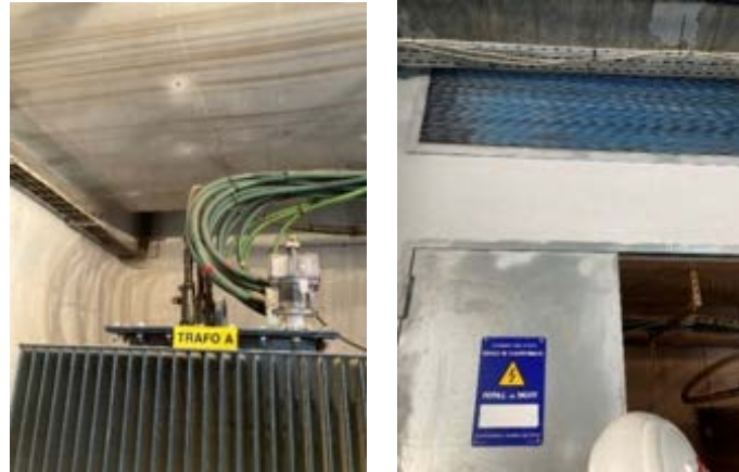
Figures 4: exemple de ventilació interior i exterior d'una ET
